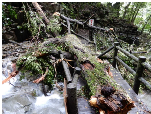
倒木に伴う歩道橋の破損
